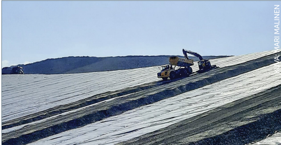
Osana sivukivialueiden sulkemista sivukivikasan pinta muotoillaan ja kiilataan sekä pinnalle rakennetaan tiivis kalvorakenne.
